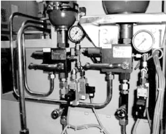
Acumuladores hidráulicos despresurizados, con líneas de presión de entrada cerradas.
